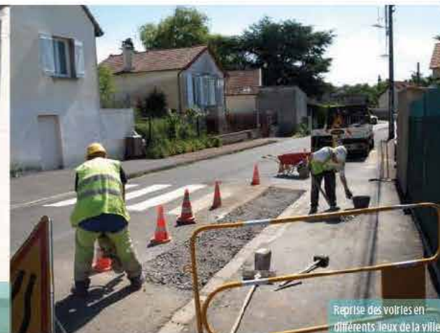
Garantir la sécurité de tous : pose de barrières pour la protection des piétons et cyclistes
